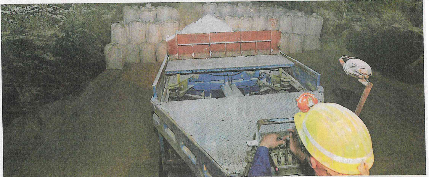
Die Salzwerke wollen Bereiche unter Biberach und Kirchhausen verfüllen: Der Müll wird über den Schacht bei Kochendorf in die Tiefe befördert und dann unter Tage zum Lagerort gebracht.
